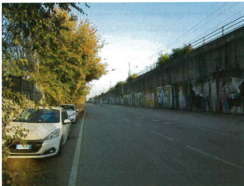
Vista del muro di sostegno del tratto sopraelevato della linea ferroviaria Milano – Treviglio.
