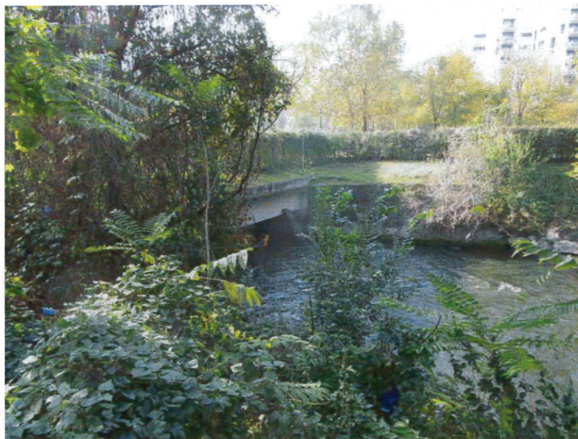
Vista del tronco d'albero incastrato in corrispondenza della sezione di ingresso del ponte "Ex Innocenti 3".
